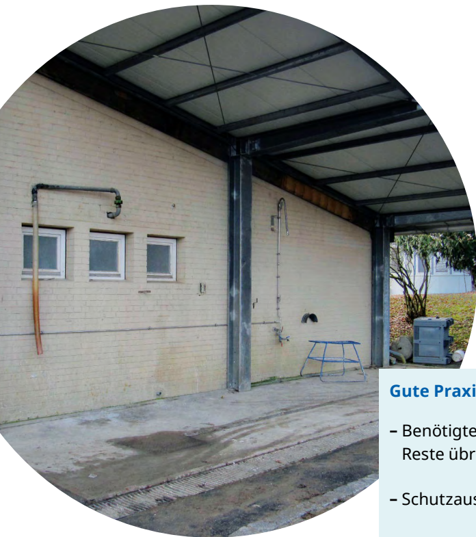
Stationärer Befüllplatz mit Gefälle, Überdachung und Ableitung in einen Sammelbehälter
