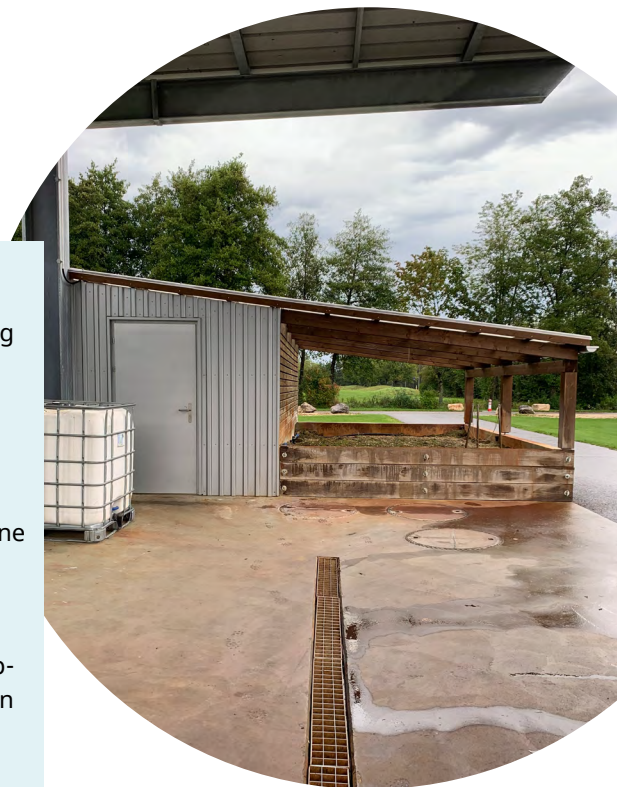
Waschplatz mit Behandlungssystem
