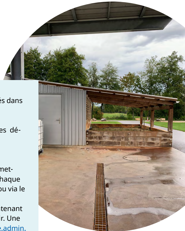
Aire de lavage avec système de traitement
