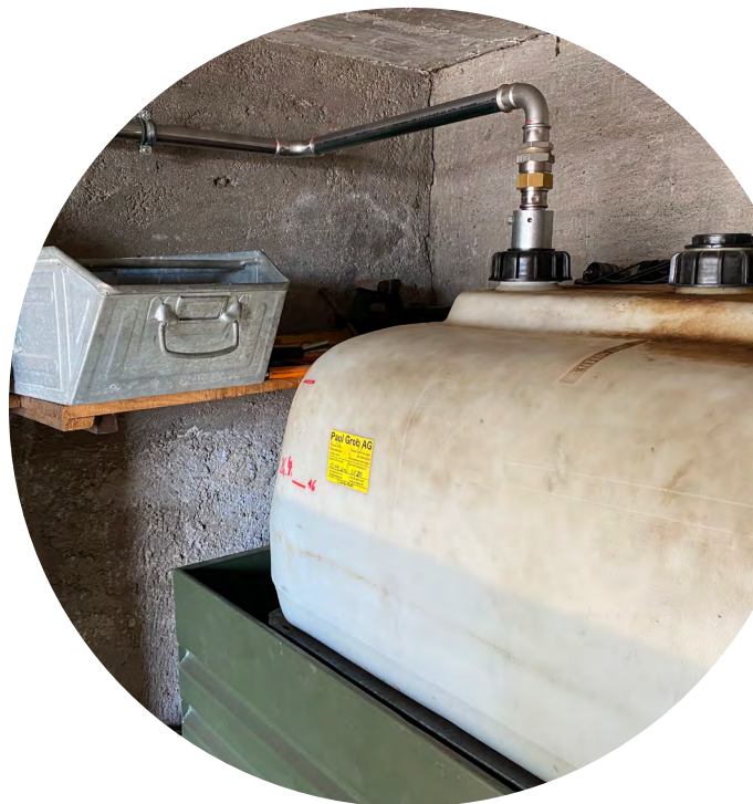
Réservoir de collecte installé en surface avec bac de rétention
