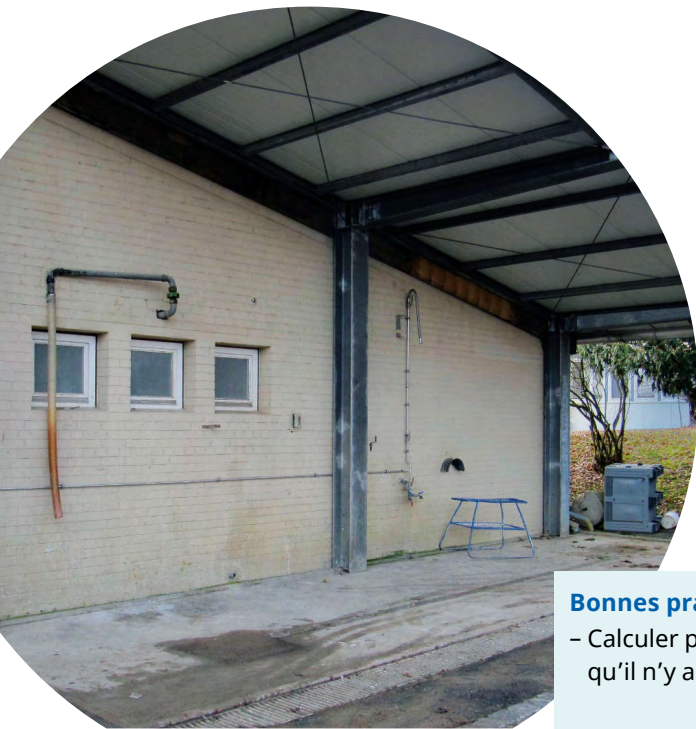
Aire de remplissage fixe avec sol en pente, toiture et évacuation des déversements dans un récipient de collecte
