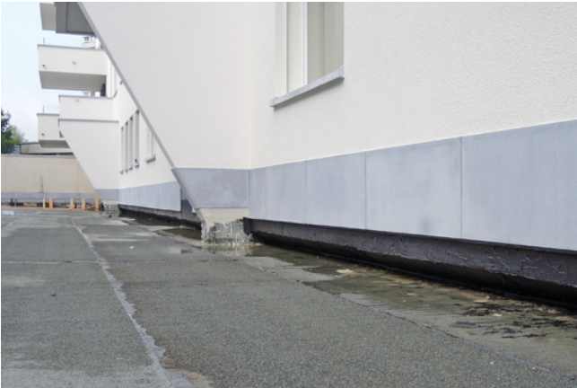
Abb. 3 Spritzwasserschutz durch Sockelelemente.
