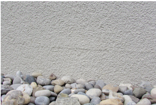
Abb. 2 Abzeichnung der Sockeldämmplatte beim Materialübergang.
