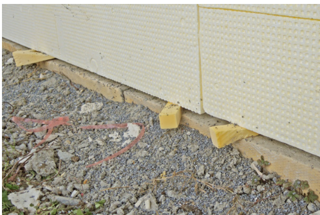
Abb. 10 Anschluss der Sockeldämmplatte zur bauseitigen Perimeterdämmung. Dieses falsch ausgebildete Detail (offene Fuge) bildet eine Wärmebrücke in der VAWD.
