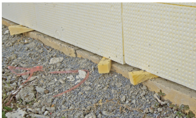
Fig. 10 Raccord des panneaux isolants de soubassement à l'isolation périphérique posée par les soins de la DT. L'exécution fautive de ce détail (joint ouvert) génère un pont thermique dans l'ITEC.
