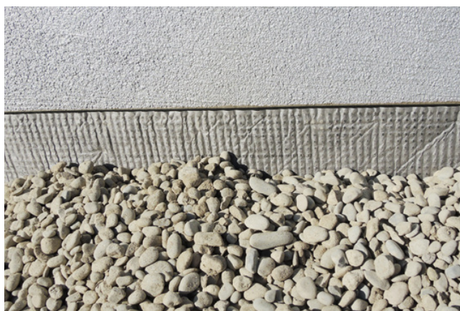
Fig. 6 Natte drainante résistante à la compression (voile non-tissé posé à l'extérieur), protégeant la façade contre toute détérioration mécanique consécutive au remblayage avec du gravier rond.
