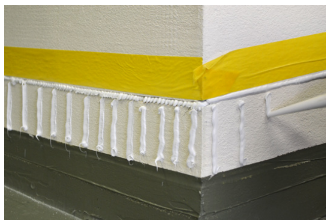
Fig. 11 Application verticale de la colle pour la pose du blindage de soubassement.
