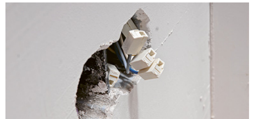
8 Aus der Wand herausragende, isolierte Drähte.
