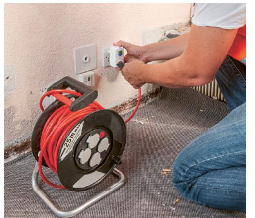
4 Kabelrolle über mobile Fehlerstrom-Schutzeinrichtung (FI-Schutz/RCD) betreiben.
