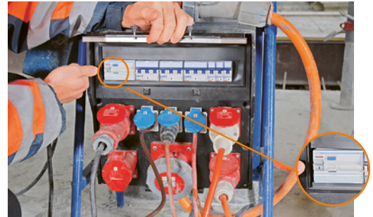
6 Steckdosenverteiler mit Fehlerstrom-Schutzeinrichtung (FI-Schutz/RCD). Funktionsfähigkeit des FI-Schutzes prüfen (vor Arbeitseinsatz, nach Herstellerangaben).
