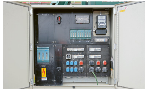
5 Baustromverteiler dürfen nur von konzessionierten Installateuren angeschlossen werden.
